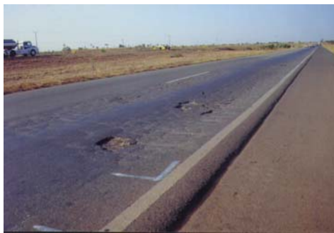
Daños en un pavimento convencional
