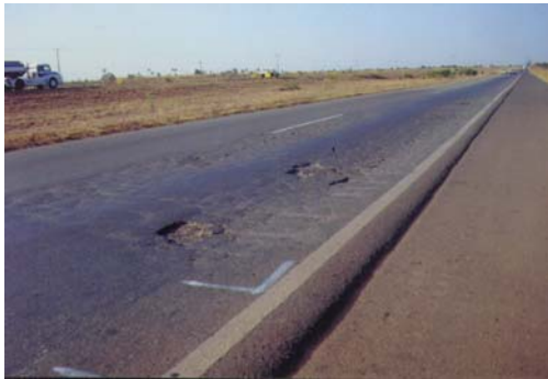
某传统公路的损坏(未采用土工合成材料)
