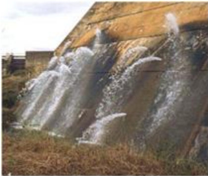
Sızıntı yapan baraj (*)
