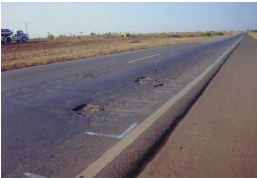
Danni in un pavimentazione stradale convenzionale (*)
