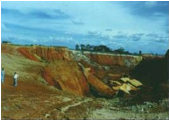
侵食による被害
